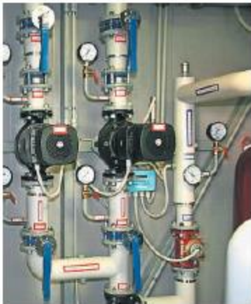
In vielen Heizungskellern schlummert Sparpotenzial. Foto: Yury Maryunin/Fotolia
