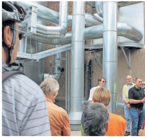
Faszination Fernwärme: Die Rohre liefern Gas von der sechs Kilometer entfernten Deponie Vogelsang an. Fotos: Feinäugle
