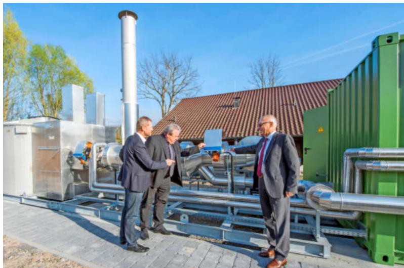
Freuen sich über die neue Gas-Behandlungsanlage auf der Deponie Vogelsang (v. l.) Markus Hohmann, Wilfried Hajek und Ataman Turanli. Foto: Mario Berger
